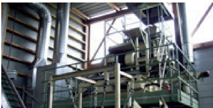
Installation de traitement des filtres (Rütli b. B.)
